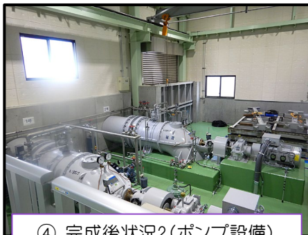
④ 完成後状況2(ポンプ設備)
